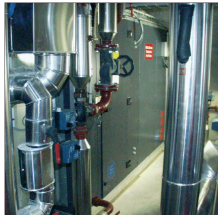
La centrale de traitement d'air est installée en local technique.
