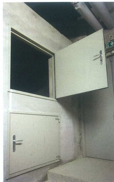
Dans les sous-sols du centre sportif, les veines d'air maçonnées permettent un accès total pour la maintenance.
