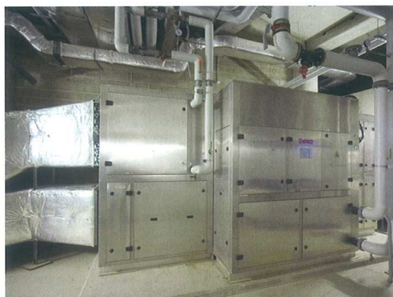
Outre les CTA à récupération enthalpique, le centre L'Odyssée est doté de deux CTA à récupération par détente directe fournies par Thereco. L'un d'elle en particulier traite la patinoire ludique.
