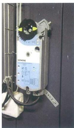
Les centrales Ecomodul sont lourdement équipées de sondes et actionneurs Siemens.
