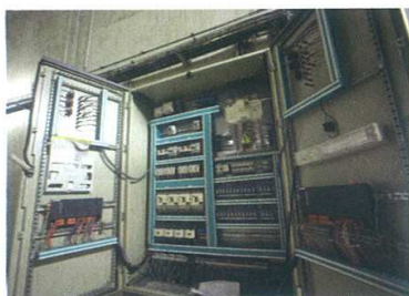
ÉcoÉnergie fournit, avec chacune de ses centrales, le tableau électrique entièrement équipé pour sa gestion.
