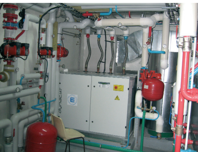
La centrale simple flux est associée à une unité thermodynamique eau/eau CIAT qui assure une déshumidification thermodynamique de la piscine en période de brouillard.
