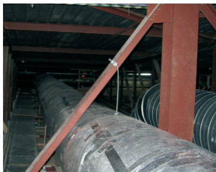
Des cheminements ont été créés dans le plénum pour faciliter le travail des opérateurs de maintenance. Le conduit de ventilation fait office de garde-corps.
